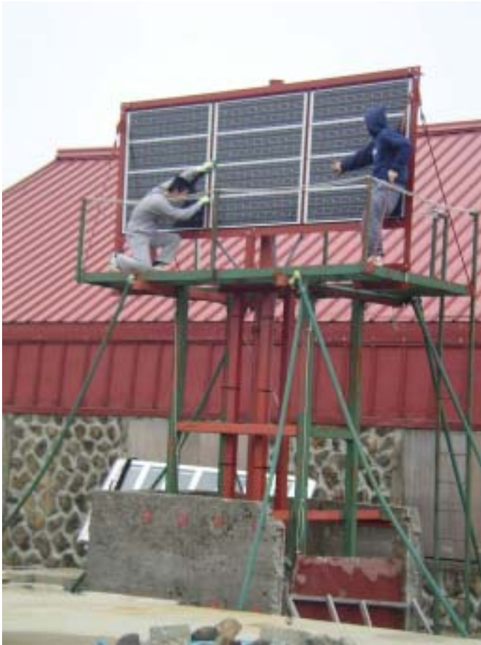
図：乗鞍観測所に設置された太陽電池パネル。
